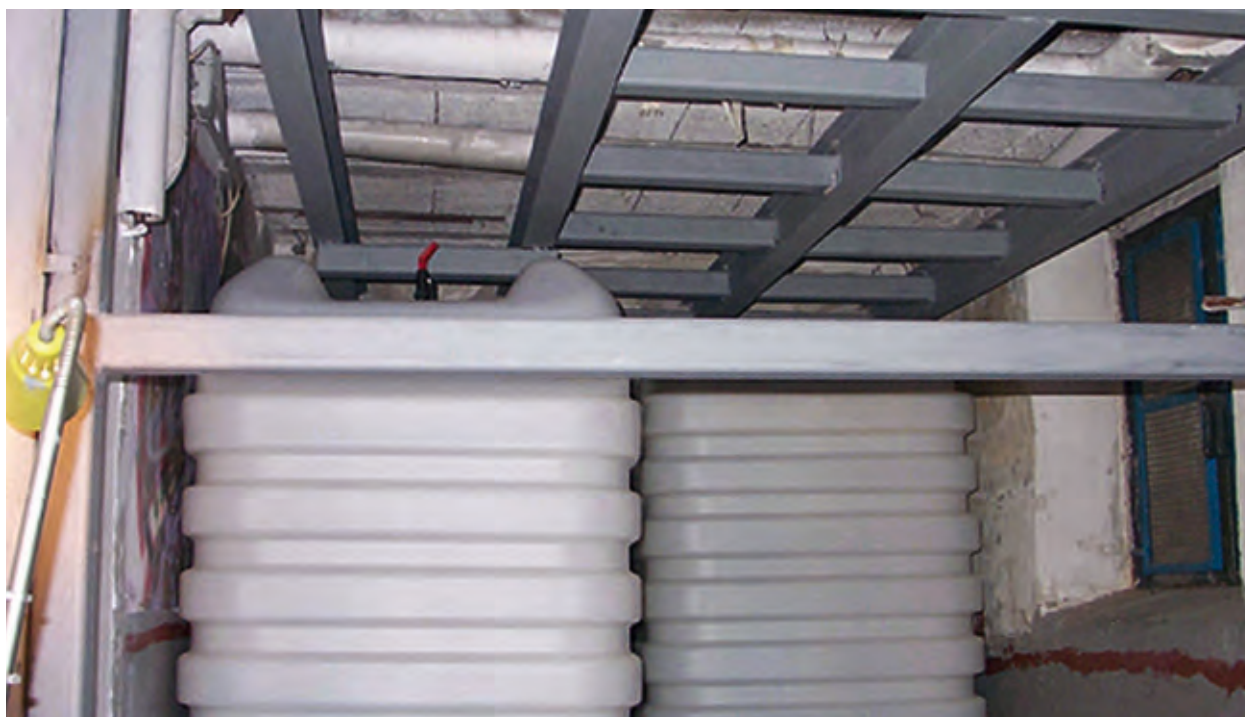
Heizöltankanlage mit Auftriebsicherung
