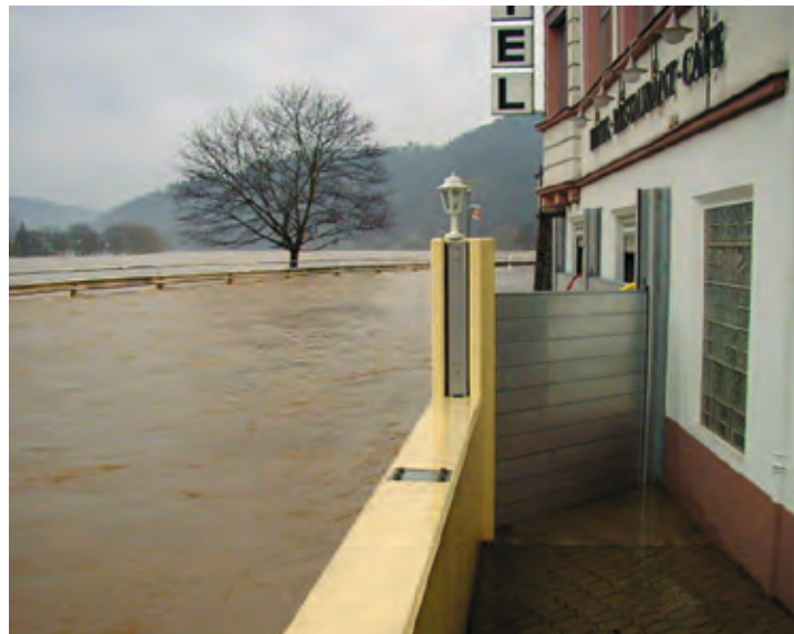
Umlaufender Hochwasserschutz mit teilmobilen Schutzelementen
